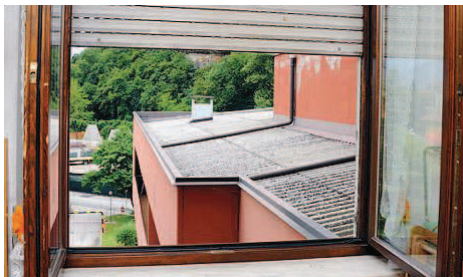
L'appartamento di Elisa Vanzo con vista sul tetto in amianto
